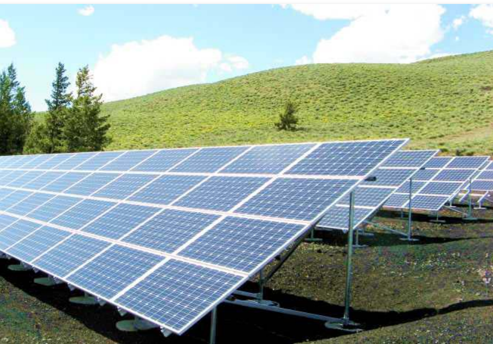
Esempio di impianto fotovoltaico
